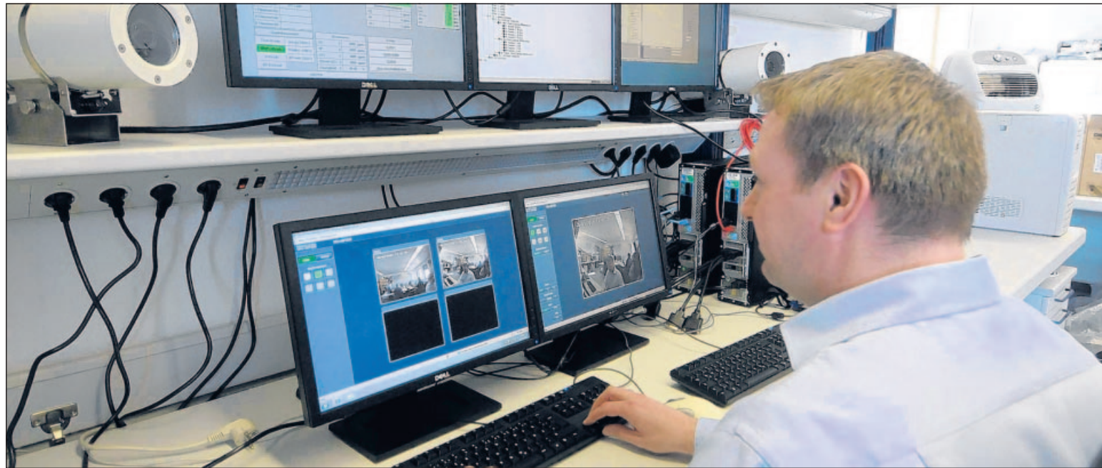
Projektleiter Frank Matz am Testaufbau eines Prozessleitsystems für die Qualitätsabfüllung von Gefahrstoffen mit integrierter Kameraüberwachung. Die Anlage soll rein automatisiert laufen.
