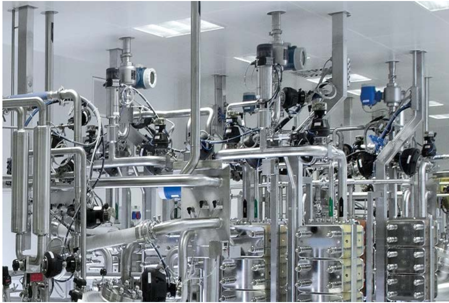
Bild: „Produktionsanlage der Pharmaindustrie.jpg“ (fotolia / Urheber: werbefoto-burger.ch)
